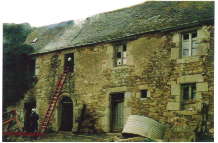
Un incendie détruit la charpente et la couverture Photo Robert Keryer
